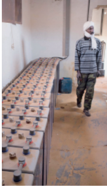
Hôpital de Smara : la salle des batteries
