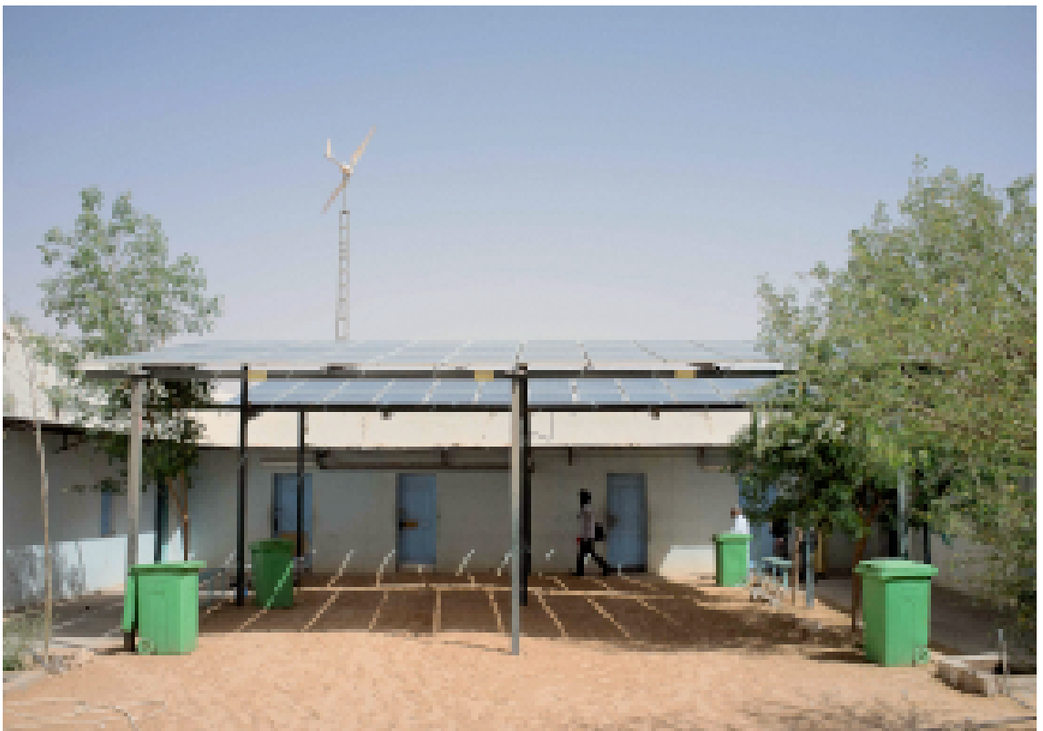
Hôpital de Smara: une belle installation réalisée par des ONG italiennes, sans beaucoup de maintenance... mais beaucoup de problèmes techniques.
