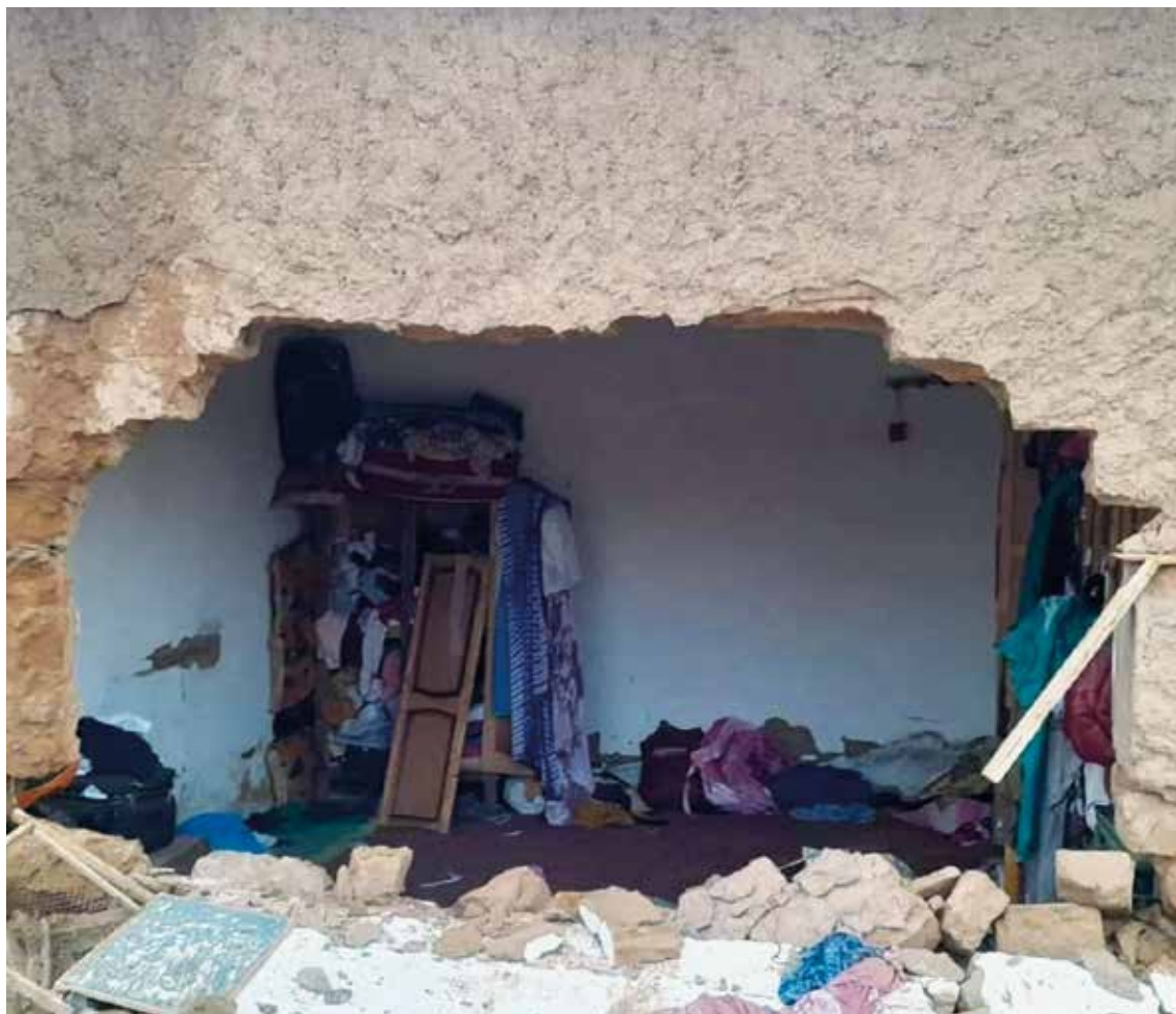
Une chambre saccagée par l'eau.
